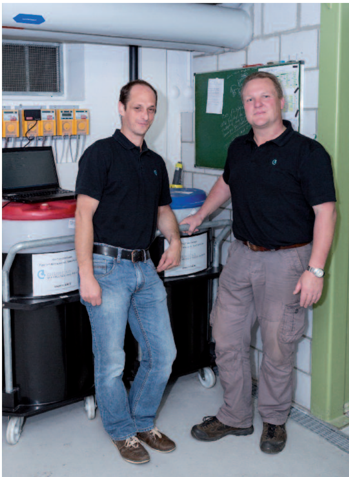
Die beiden Spezialisten von der Chemie AG, Richi Schnyder (Techniker) und Rolf Gerber (Leiter Logistik), freuen sich über den Erfolg ihrer Dosieranlage im Alters- und Pflegeheim Bad-Ammannsegg.
