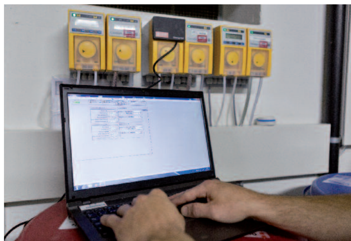
High-Tech im Keller des Alters- und Pflegeheims: Der Techniker der Chemie AG programmiert und überprüft die Dosieranlage direkt via seinem Laptop.
